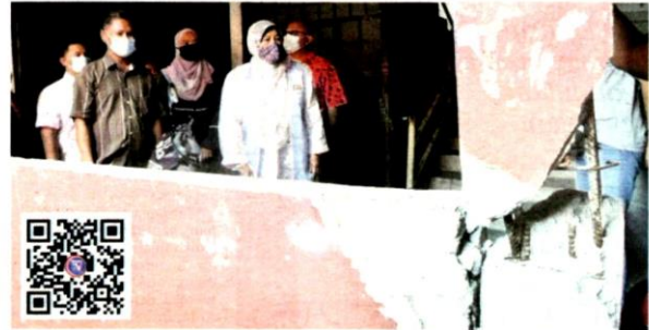
ZURAIDA (kanan) melihat keadaan struktur bangunan yang mengalami keretakan ketika mengadakan lawatan di flat Taman Sri Berembang. --
